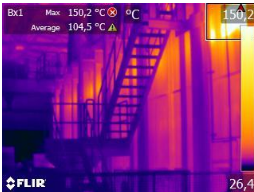
Termografia su forno per trattamento termico con problema di coibentazione
