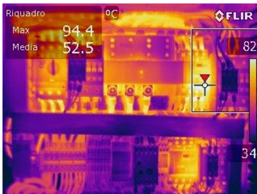
Termografia sezione quadro con problema di dissipazione termica
