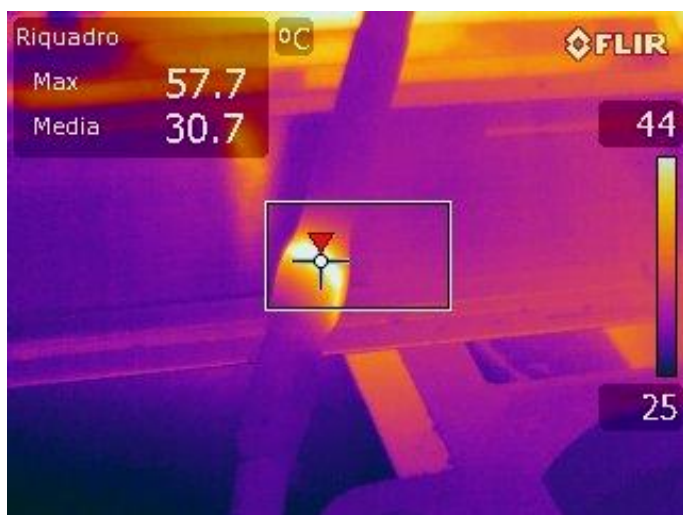
Termografia giunzione cavo media tensione difettosa
